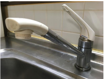
【施工前コメント】 SANEI 混合水栓 【水栓パッキン部より小漏水】
